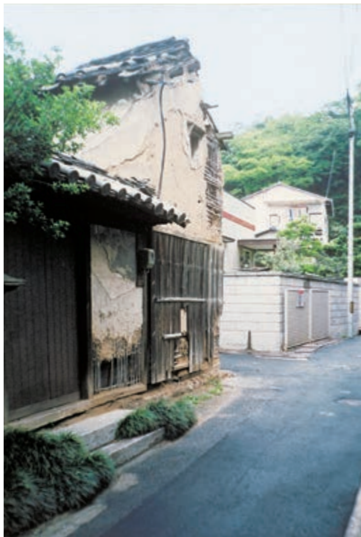
改修前の「角屋」 Kadoya on the verge of collapse.
